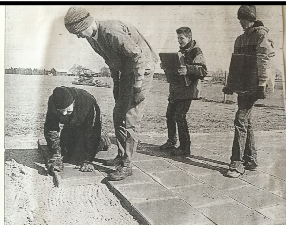
Utslagsplats. Arbetet med utslagsplatsen för drivningranchen i Reftele pågick under lördagen. På bilden är det Mats Bergkvist, John Pantzar, Fredrik Grahn och Björn Pantzar som lägger cementplattor. Foto: HÅKAN JOHANSSON
